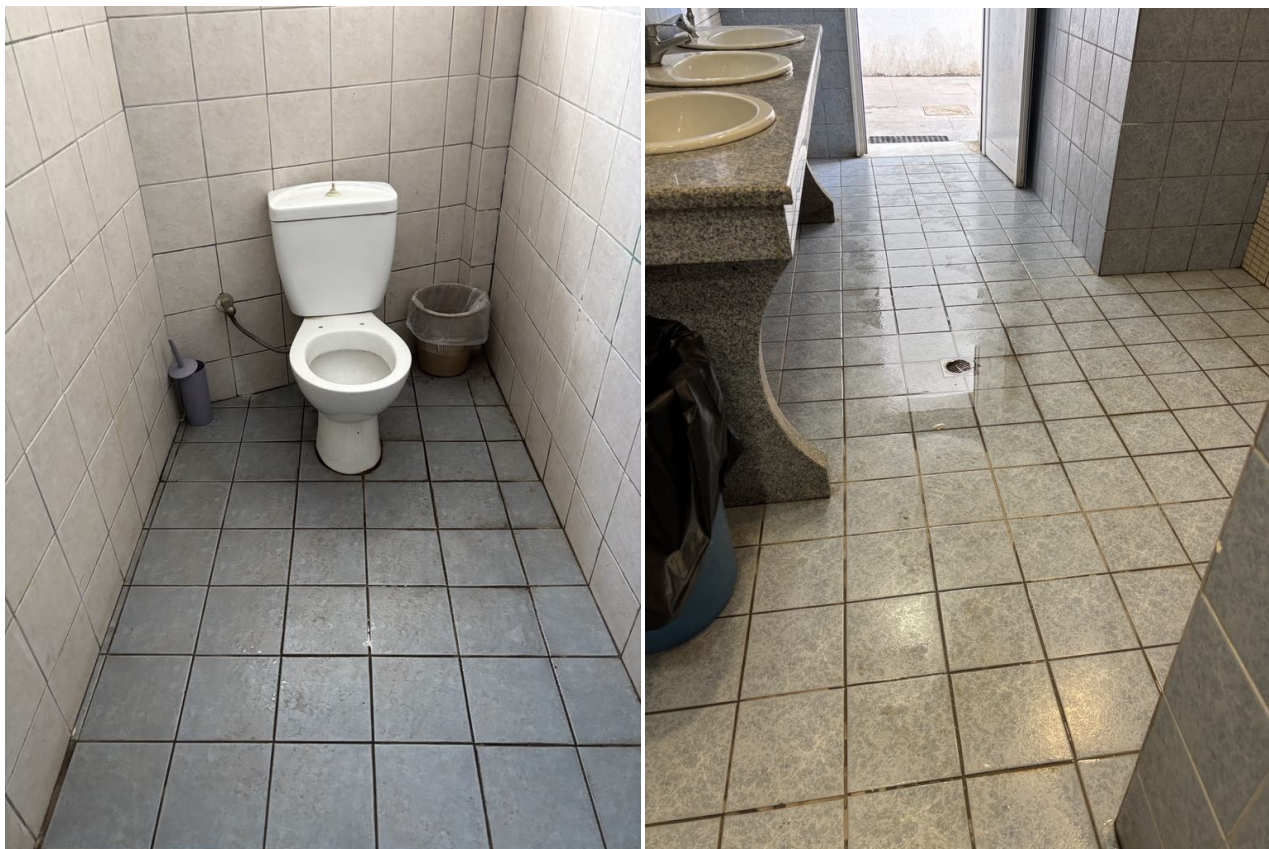
1.1 Τουαλέτες χωρίς καπάκια, χωρίς χαρτί. 1.2 Βρώμικα νερά και ακαθαρσίες στο δάπεδο
