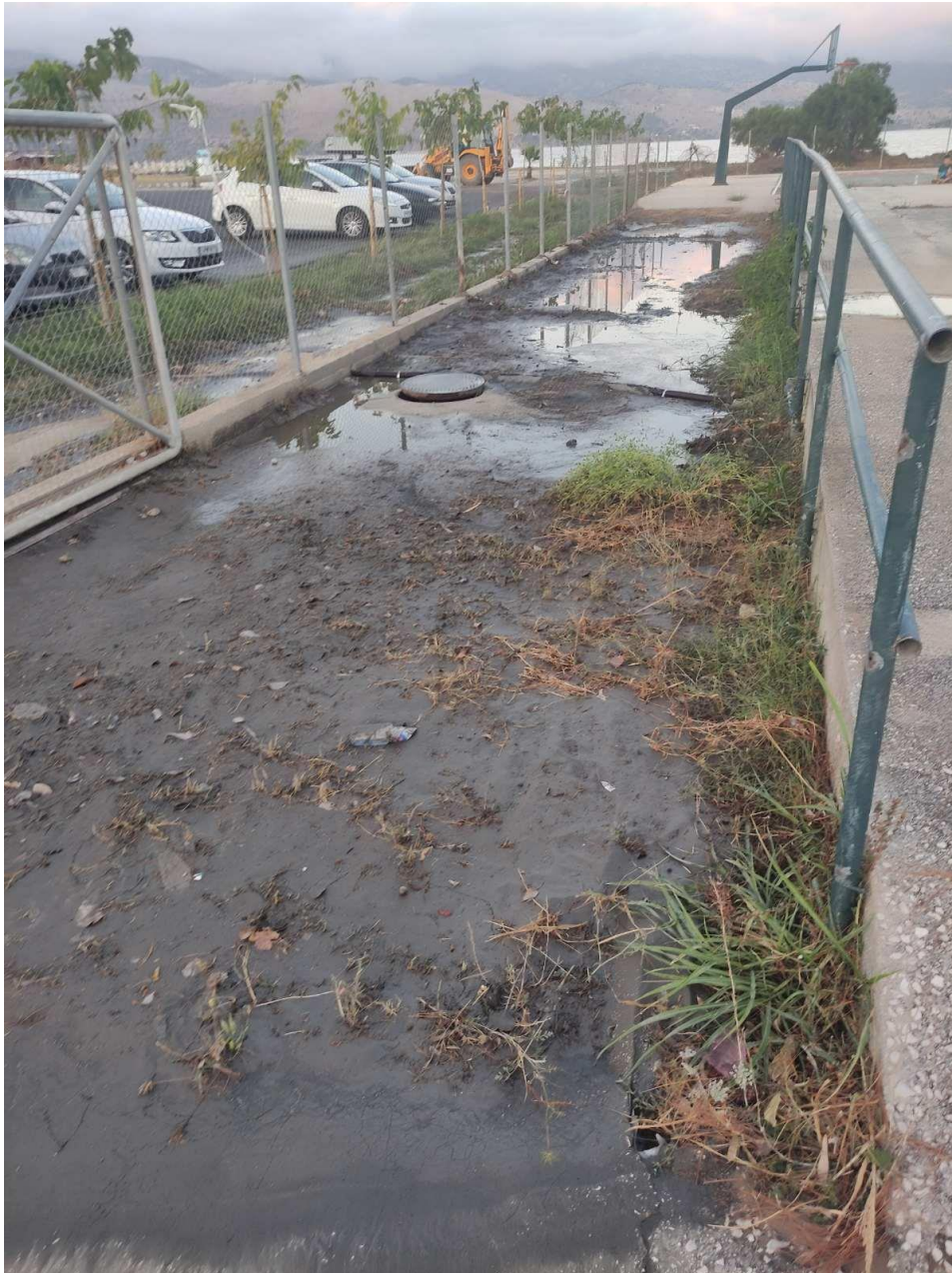
Φωτ. 3 Υπερχείλιση αγωγού ομβρίων και λυμάτων
