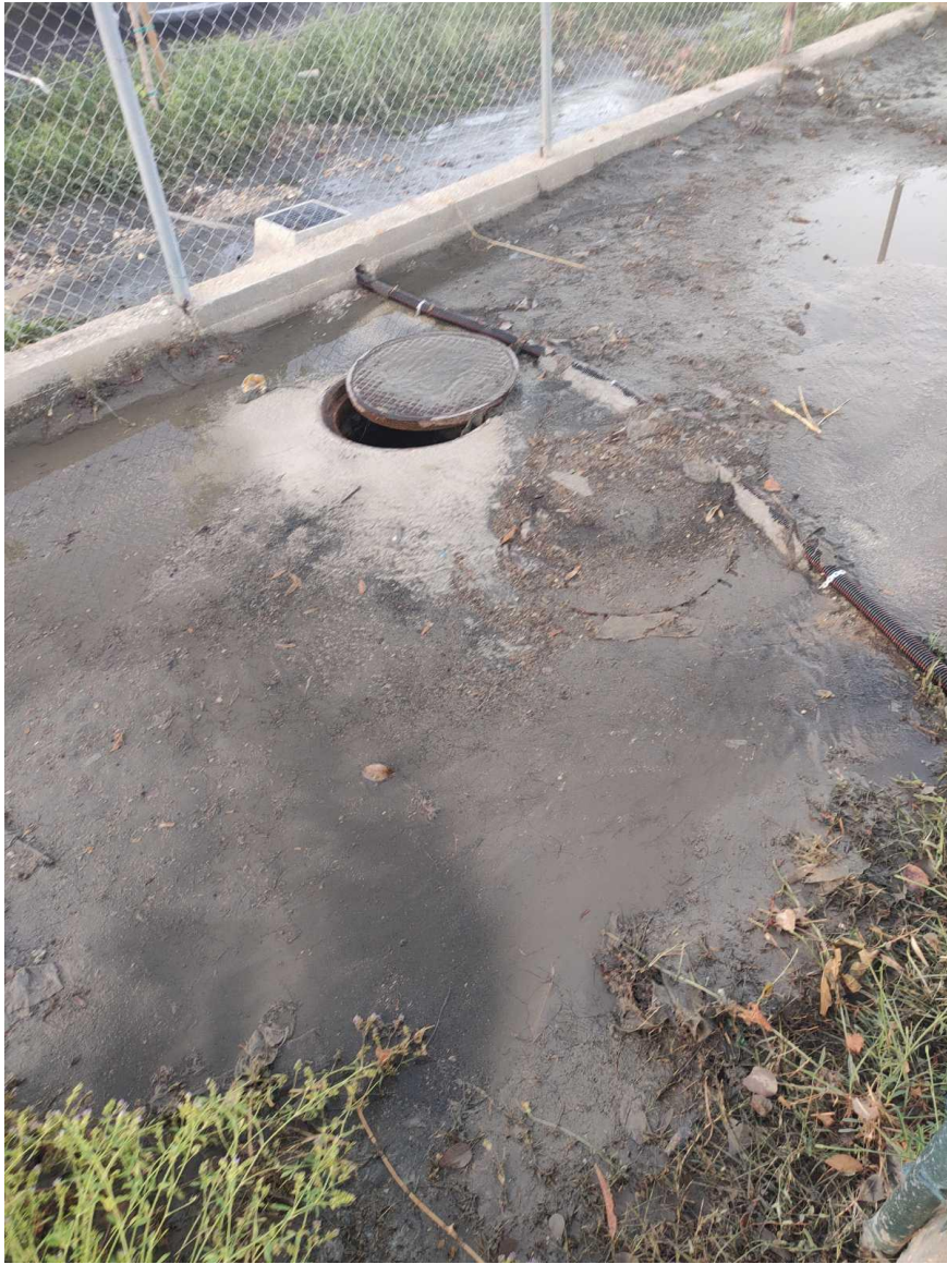
Φωτ. 4 Υπερχείλιση αγωγού ομβρίων και λυμάτων
