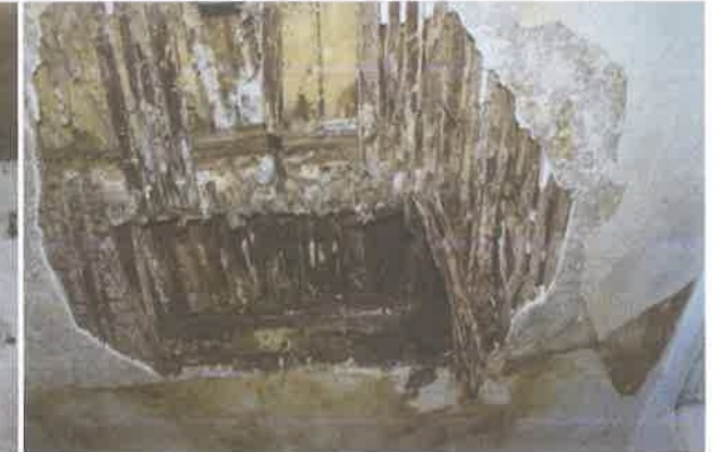
Φωτ. 20. γ. Υ.08 Οροφή υπογείου
