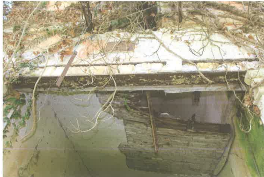
Φωτ. 256. Τα φυτά διεισδύουν στην κατασκευή διαβρώνοντας και αποσυνθέτοντας ότι έχει απομείνει μέχρι σήμερα.
