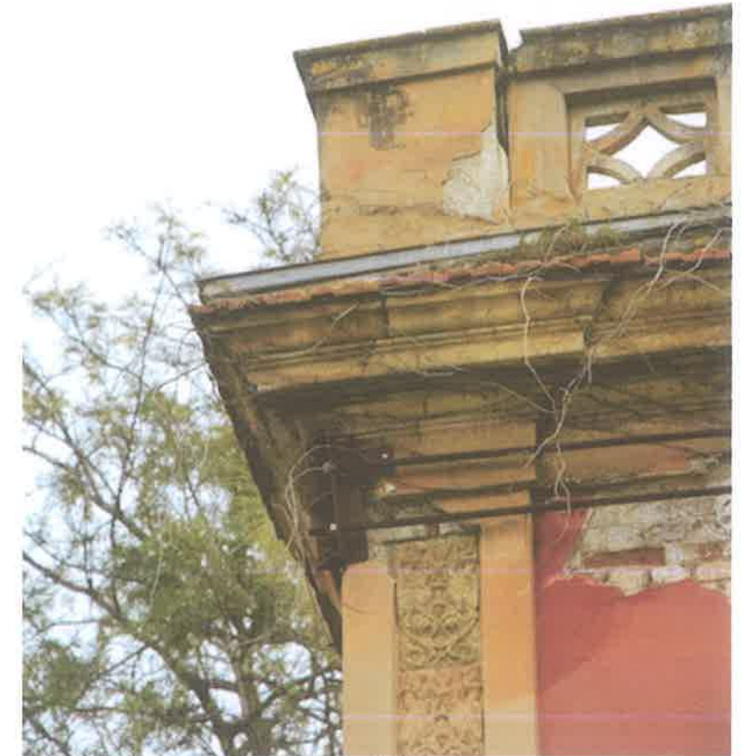
Φωτ. 177. τάσεις αποκόλλησης των στηθαίων
