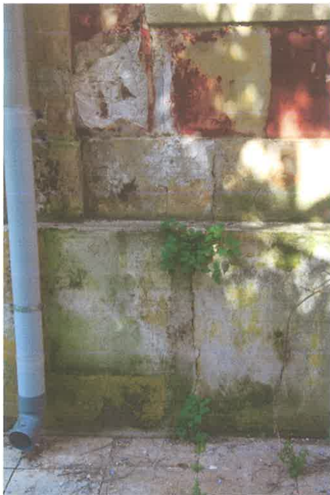
Φωτ. 205. ανιούσα υγρασία
