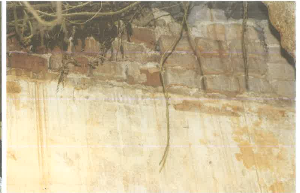
Φωτ. 248. χ. ΙΣ.04
