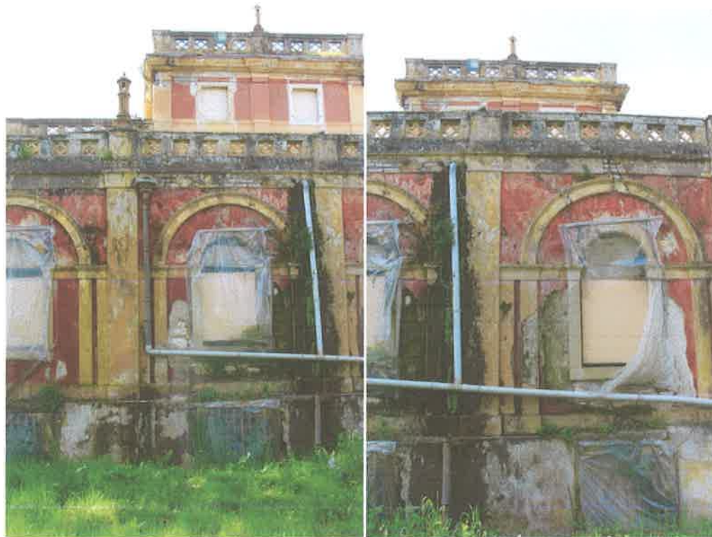
Φωτ. 187. διάβρωση των επιχρισμάτων από την κακή συντήρηση του συστήματος απορροής όμβριων υδάτων και ανάπτυξη φυτικών οργανισμών / προβλήματα από ανιούσα υγρασία Ανοιγμα στο επίπεδο έδρασης δοκών, αστοχία των ανακουφιστικών τόξων
