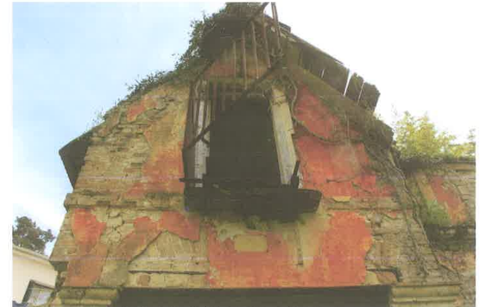
Φωτ. 257. Οξείδωση μεταλλικών δοκών / έντονες ρηγματώσεις από αστοχία πρεκιών / πλήρης αστοχία των επιχρισμάτων.
