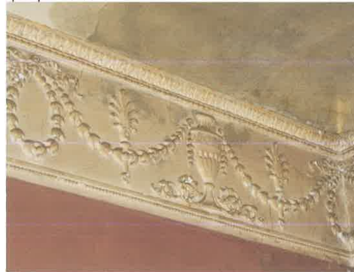
Φωτ. 118. Διακοσμημένη περιμετρική ζώνη στο ανώτερο τμήμα της τοιχοποιίας. Διακρίνονται φυτικά μοτίβα και στοιχεία που παραπέμπουν σε κυμάτια αρχαίων ρυθμών Πηγή: Ερευνητικό Ε.Μ.Π.
