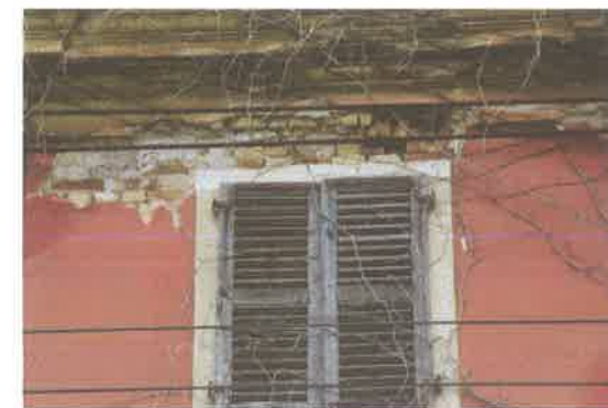
Φωτ. 181. οι φθορές με το πέρασμα του χρόνου προχωρούν και στην αποσάθρωση των κονιαμάτων της τοιχοποιίας
