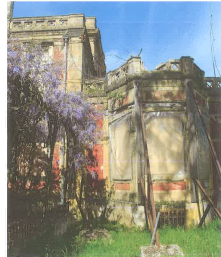
Φωτ. 136. Νοτιοανατολική όψη απόκλιση προσθήκης από την κατακόρυφο
