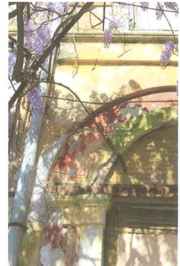
Φωτ. 207. τα πρόχειρα μέτρα αντιστήριξης προκαλούν δευτερογενείς βλάβες από την πίεση της στήριξης διογκώνεται η τοιχοποιία πιο κάτω με αποτέλεσμα την αποκόλληση των επιχρισμάτων και του τοξωτού λίθινου υπέρθυρου
