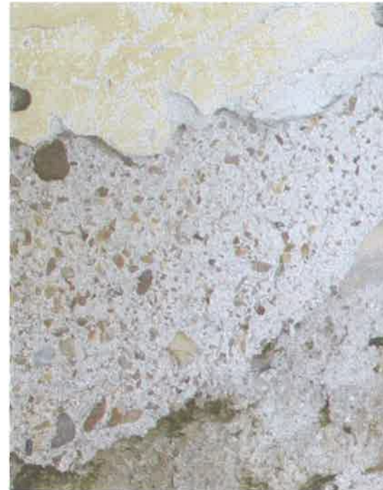
Φωτ. 81. χ.ΙΣ.03 εσωτερικό επίχρισμα
