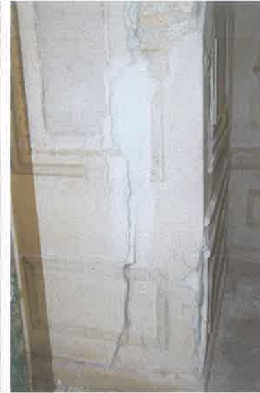
Φωτ. 164. χ. Ι.03 Ρωγμή στην επαφή της πολυγωνικής κατασκευής καθιστικού με το κυρίως κτίσμα.
