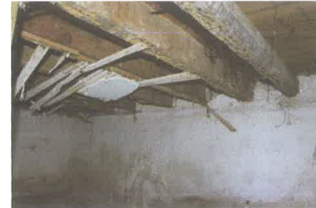
Φωτ. 19. γ. Υ.02 Οροφή υπογείου
