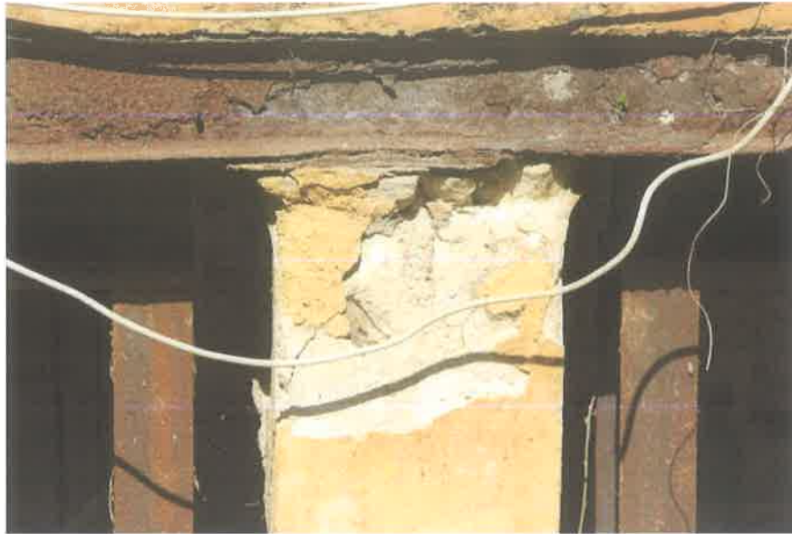
Φωτ. 202. οξείδωση των μεταλλικών δοκών στήριξης – διάβρωση και αποκόλληση επιχρισμάτων
