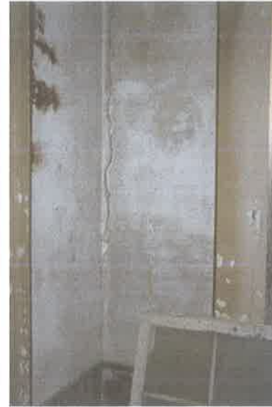
Φωτ. 163. χ. Α.03 ρωγμή στον όροφο
