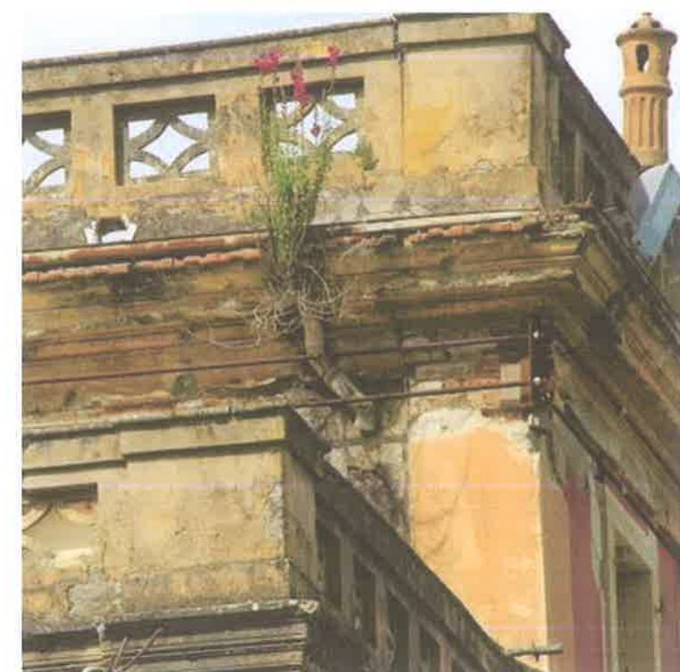
Φωτ. 137. Νοτιοανατολική όψη απορροή όμβριων υδάτων από περιμετρικό μεταλλικό ντερέ
