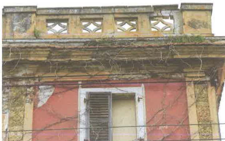
Φωτ. 178. τα στηθαία από πωρόλιθο βρίσκονται σε επικίνδυνη κατάσταση
