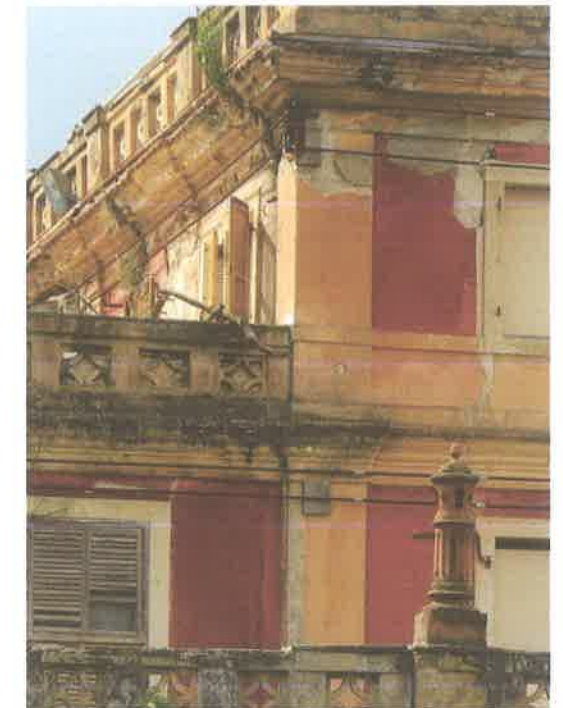
Φωτ. 192. ρωγμή στο σημείο επαφής των διαφορετικών φάσεων κατασκευής Η ρωγμή συνεχίζει και στο εσωτερικό του ισόγειου (βλ. φωτ.162 σελ. 45)
