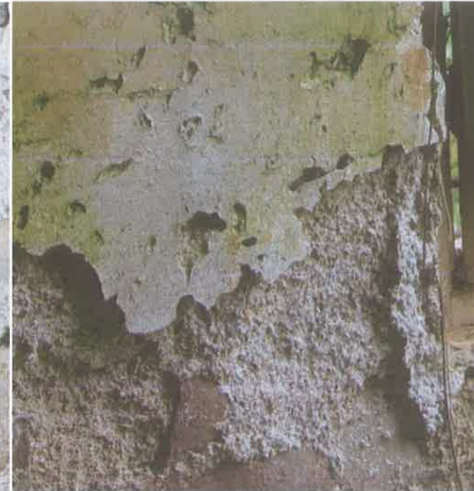
Φωτ. 82. χ.ΙΣ.05 εσωτερικό επίχρισμα
