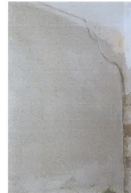
Φωτ. 165. χ.Β.02 ρηγματώσεις στην ένωση τοίχων
