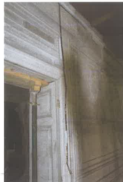
Φωτ. 167. χ. Ι.03 Διαμπερή ρηγμάτωση
