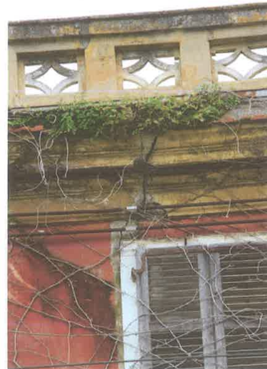
Φωτ. 179. έντονη ρηγματώση στο επίπεδο έδρασης δοκών
