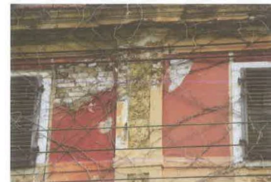
Φωτ. 180. αποκόλληση επιχρίσματος/ αποδιοργάνωση υλικού/
