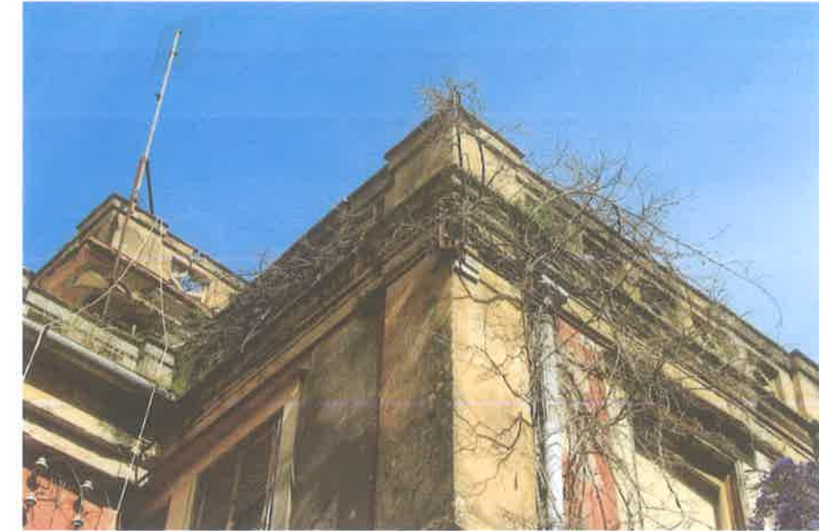
Φωτ. 204. οι φυτικοί οργανισμοί συμβάλουν στην αποσταθεροποίηση της κατασκευής
