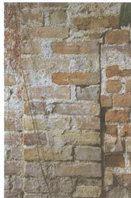
Φωτ. 51. χ.ΙΣ.06 κατασκευαστική ασυνέχεια
