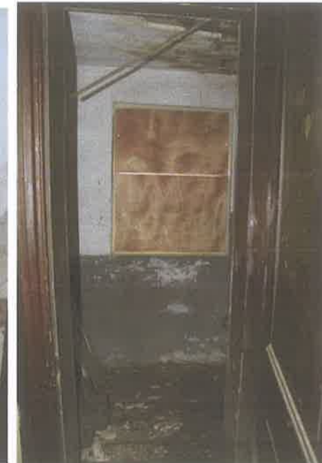
Φωτ. 166. χ. Β.02 – Μεταγενέστερη προσθήκη με εμφανή σημάδια της υγρασίας. Έχουν χρησιμοποιηθεί ευτελή υλικά
