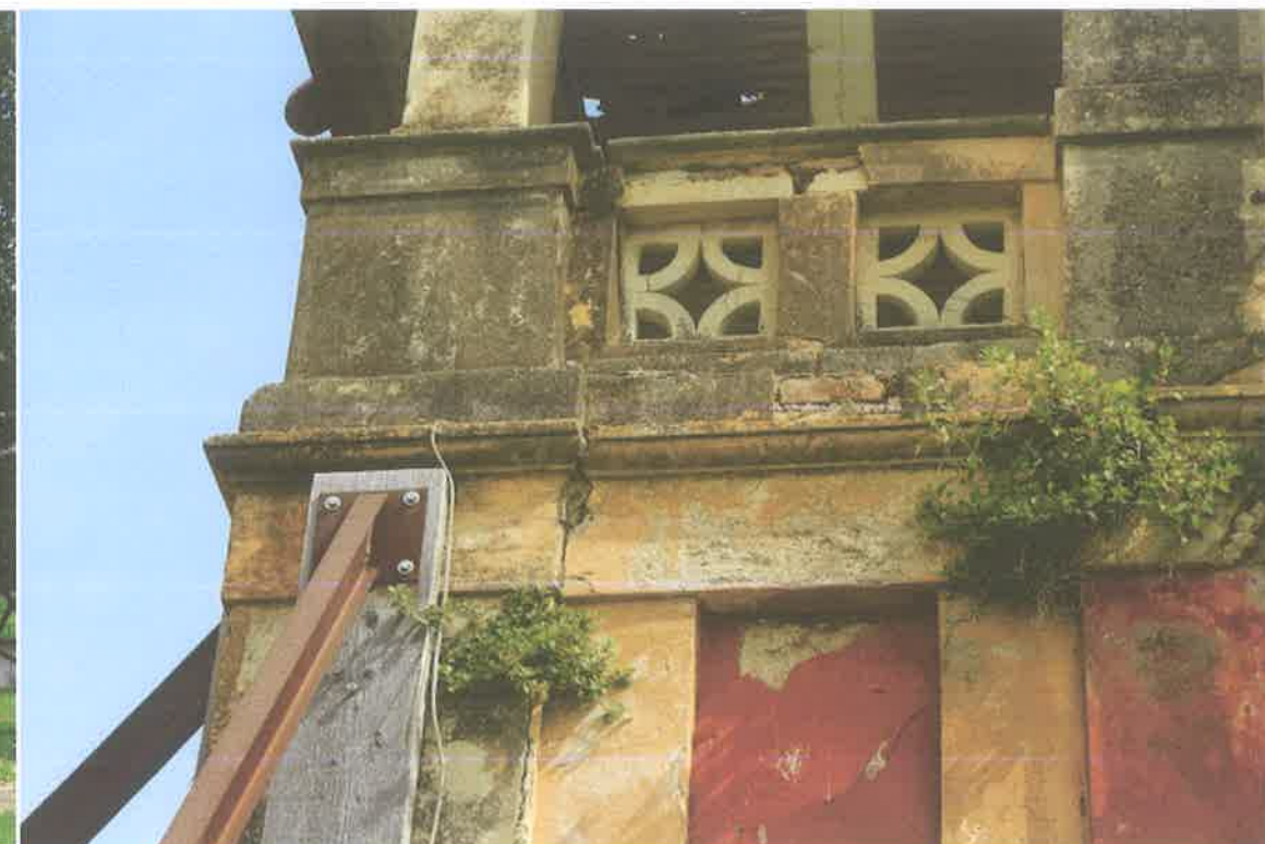
Φωτ. 210. ρηγματώση κατασκευής
