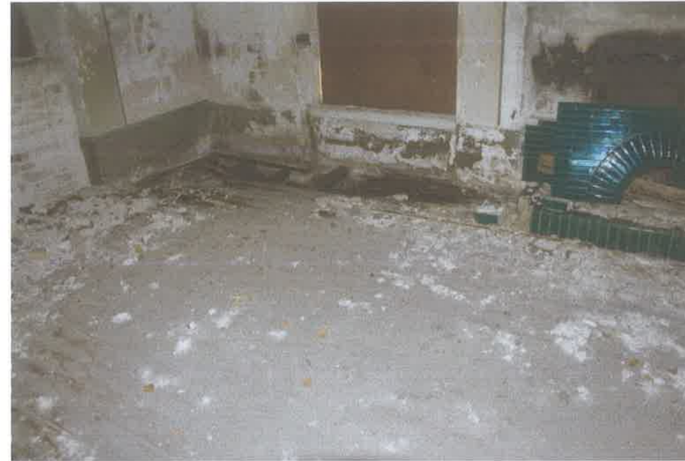
Φωτ. 35. χ. Α.03 πλήρης καταστροφή τζακιών
