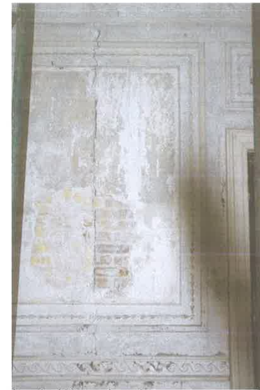
Φωτ. 4. χ.Ι.03 ρωγή ασυνέχειας
