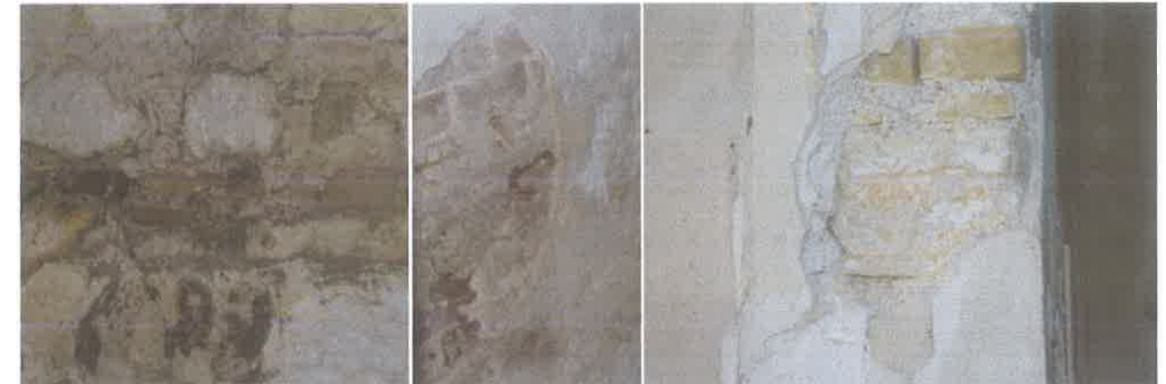
Φωτ. 9. χ. Υ.03 λιθοδομή με γεμίσματα από οπτόπλινθους Φωτ. 10.χ. Υ.03 εσωτερικός διαχωριστικός τοίχος από οπτόπλινθους Φωτ. 11.χ. Ι.03 μικτή τοιχοποιία
