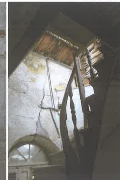
Φωτ. 170. Πηγή Ερευνητικό ΕΜΠ Ρηγμάτωση από έντονη καταπόνηση στην απόληξη του κλιμακοστασίου στο δώμα.
