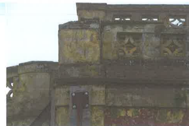
Φωτ. 191. Αποδιοργάνωση υλικού λόγω υγρασίας
