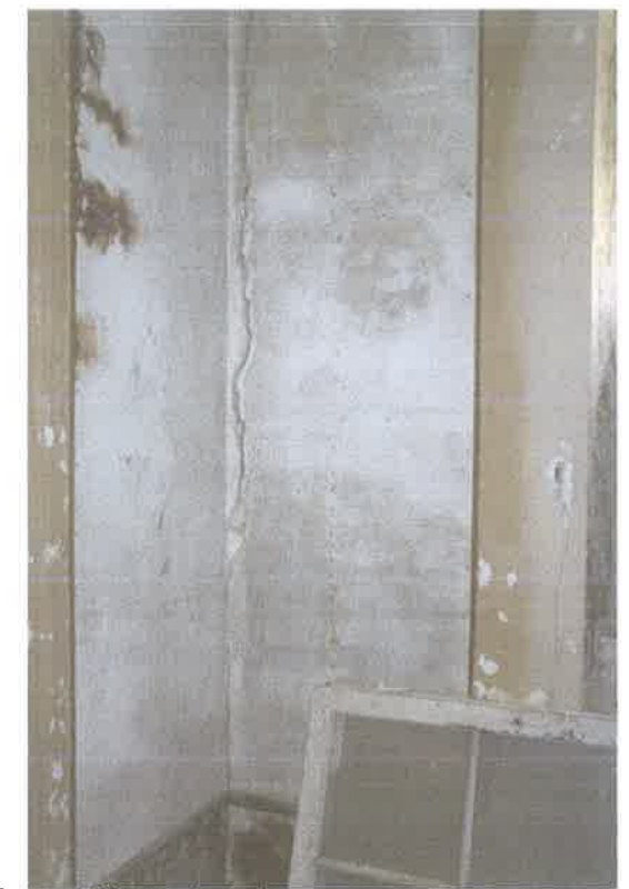
Φωτ. 5. χ.Α.03 ρωγή ασυνέχειας
