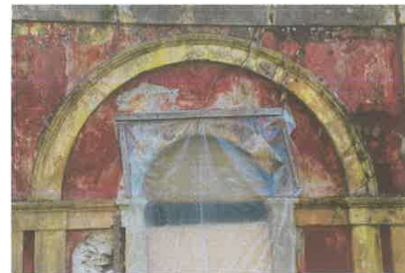
Φωτ. 189. πλήρης αποδιοργάνωση της κατασκευής
