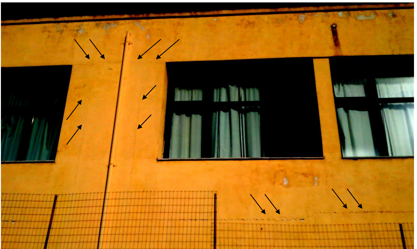
Ρωγμές στα επιχρίσματα και στην τοιχοποιία της νέας πτέρυγας
