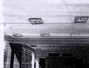
Φωτογραφία 9: Κατεστραμμένα φωτιστικά
